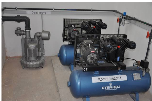
Vľavo: Dúchadlo pre kvalitný preplach filtrov. Vpravo: Aeračný systém obsahujúci kompresory.
