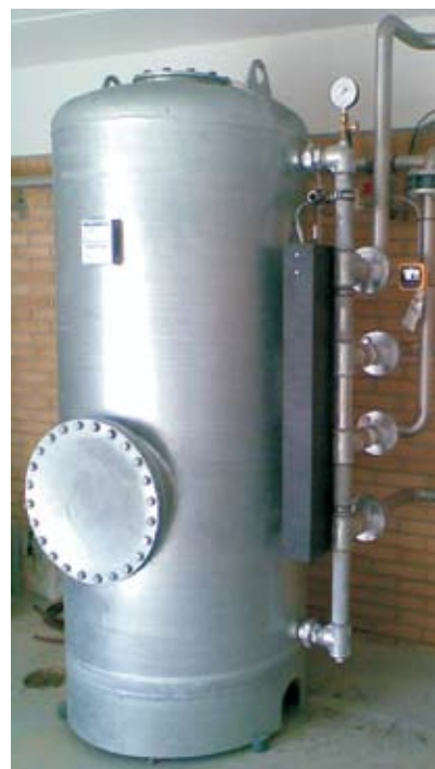
Odstraňovanie arzénu vo vodárni prostredníctvom adsorpcie. Riešenie obsahuje automatický tlakový filter typ NSB 170 inštalovaný za atmosférickými usadzovacími filtermi. Prietok: 12 m 3 /h.
