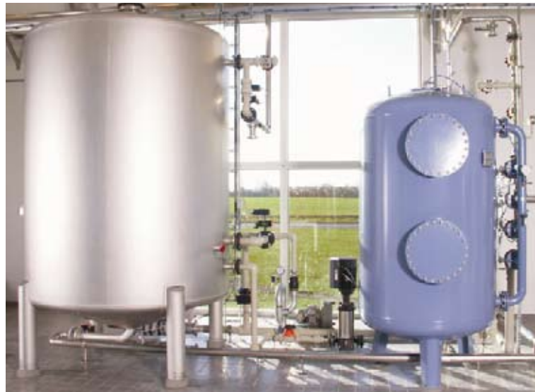
Odplynenie rozpustených plynov ako sú agresívny oxid uhličitý, metán a sírovodík je podmienkou optimálnej filtrácie. Foto: odplynenie a tlaková filtrácia v pivovare.
