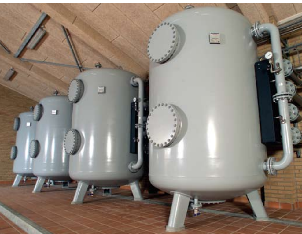
Odstraňovanie železa, mangánu a amónnych látok vo vodárni. Prietok: 2 x 35 m 3 /h.
